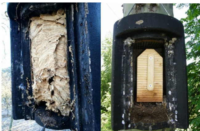
Fig. 8 - Cajas Schwegler del modelo 1FW con la tapa retirada. A la izquierda un panal de avispones; a la derecha, un nido de ave.
