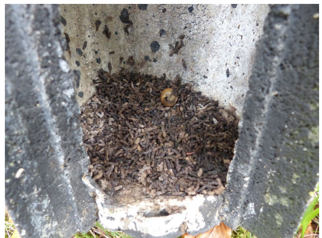
Fig. 11 - Algunas cajas requieren labores de mantenimiento para retirar ácaros parásitos (arriba) o guano de los murciélagos (abajo).
